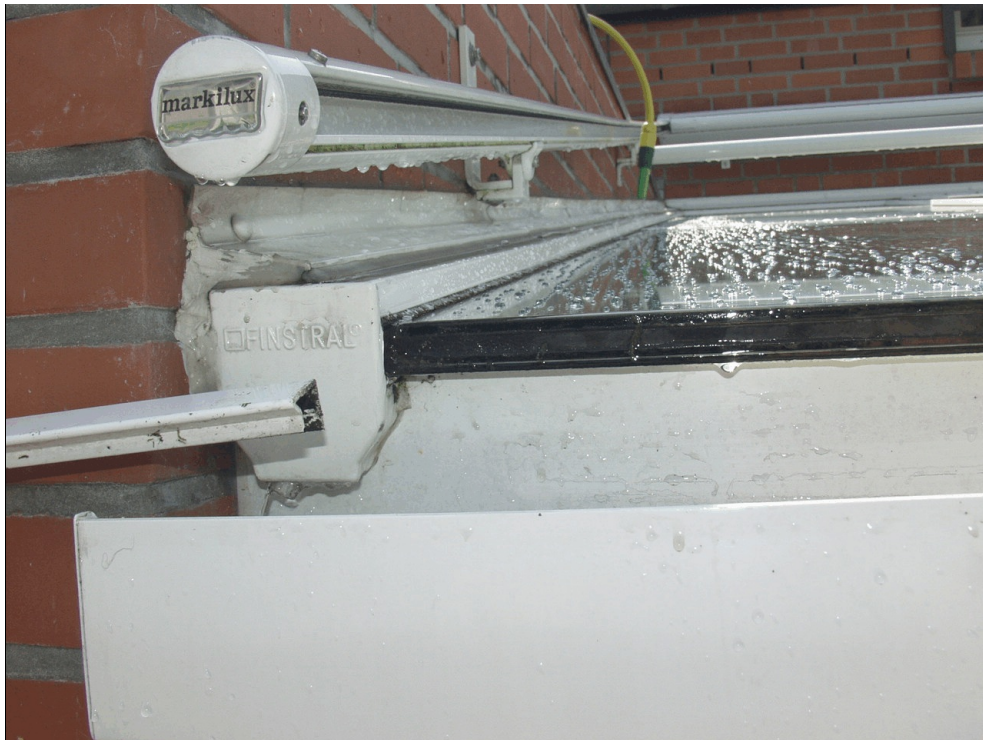
Abb. 3 Problematischer, seitlicher Anschluss an eine Brandwand
